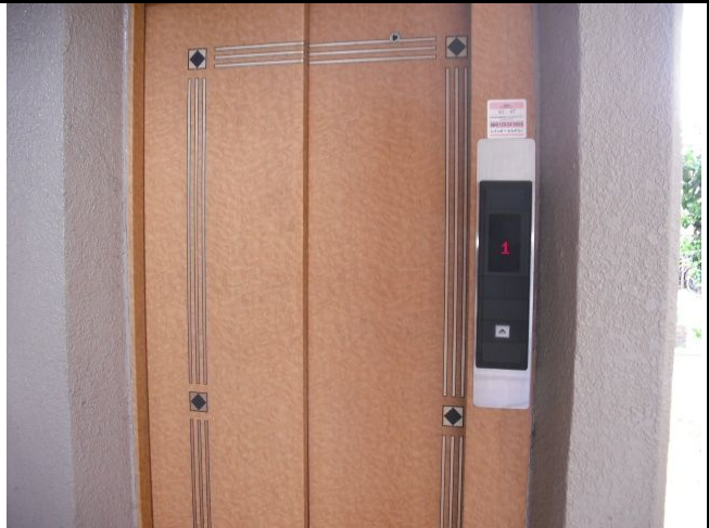
1階ホールインジケータ
