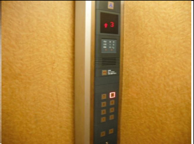
かご内操作盤
